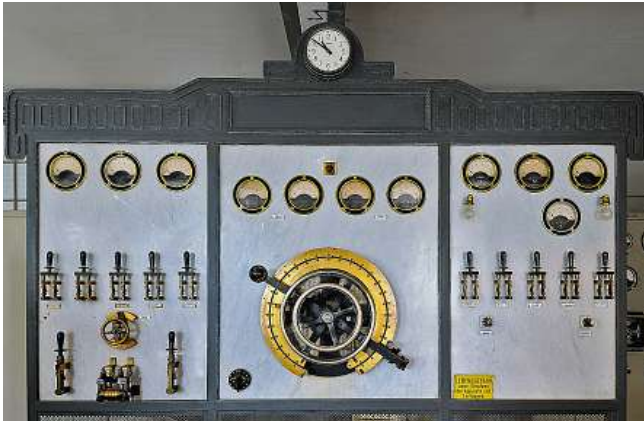
Bild 2 Alte Schalttafel im historischen Kleinkraftwerk Ottenbach (um 1910).
