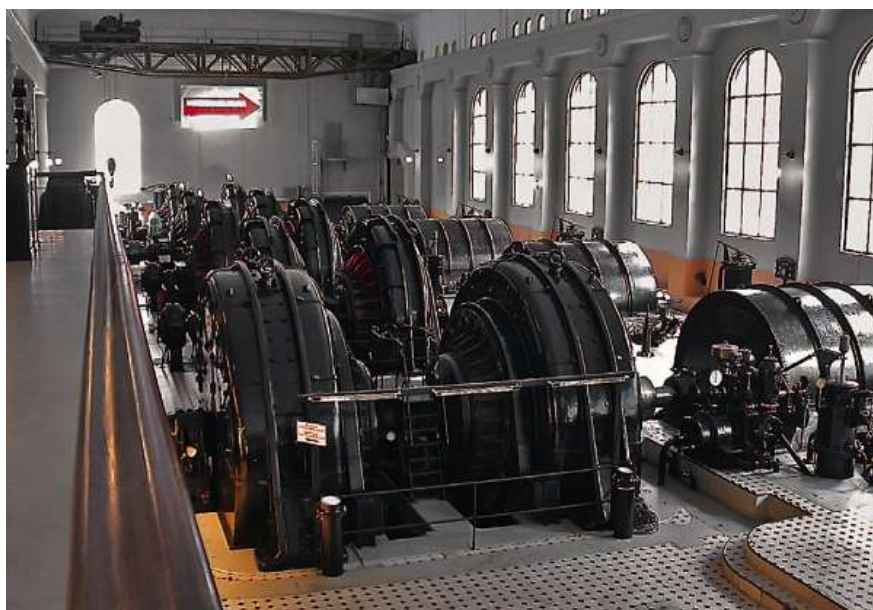
Bild 4 Maschinensaal Ausrüstungsstand ähnlich zur Situation 1929, KW Vemork (2012).
