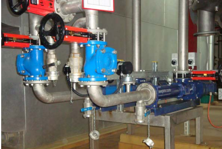
Förder- und Stellaggregate mit zugehöriger Verrohrung
